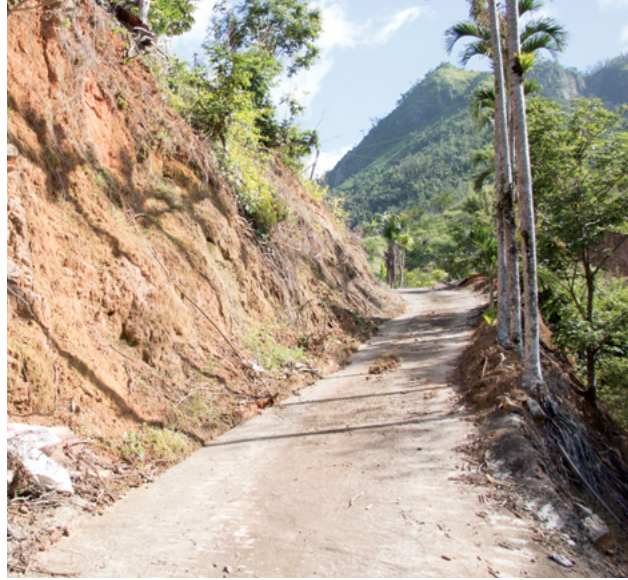
El huracán María destruyó muchas de las calles de Utuado, y las reparaciones incompletas generaron condiciones peligrosas de conducción. Crédito: Laura Galarza/Universidad Estatal de Montclair
