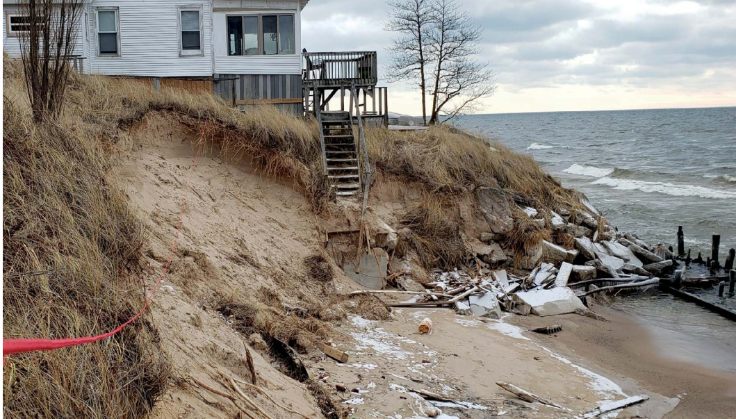
Una casa en el municipio estatutario de Grand Haven ubicada peligrosamente cerca de la orilla en diciembre de 2019, luego de varios meses de tormentas intensas. Crédito: Cortesía del municipio estatutario de Grand Haven.
